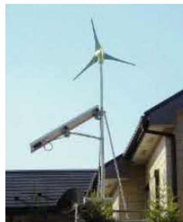
写真：小型風力発電機
