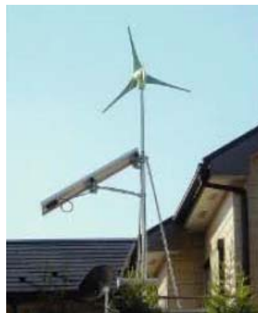
写真：小型風力発電機
