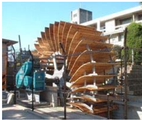
写真：小水力発電機（山梨県都留市）
