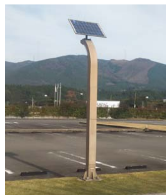
写真：太陽光発電付街路灯 （グリーンパークえびの）
