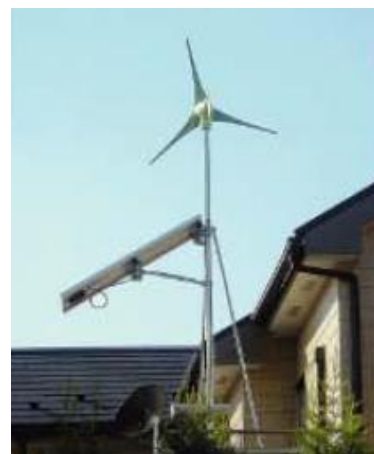
写真：小型風力発電機
