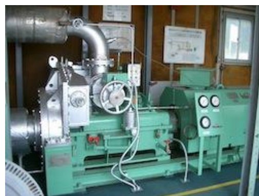
写真：ホテルに設置された地熱発電設備
