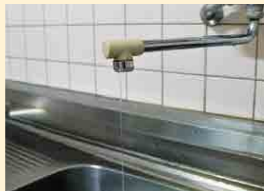
水抜きをしない場合は、糸を引く程度の水を出して凍結を防ぐ
