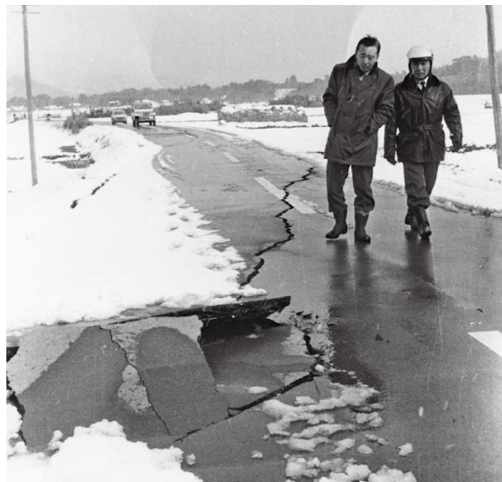
地震により隆起、地割れした道路
