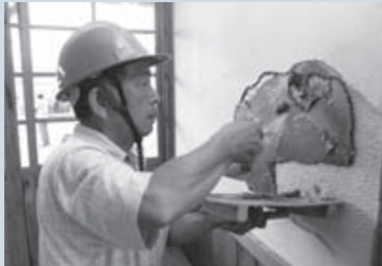
はがれ落ちた駅舎の内壁を修繕する市建築技能連合会会員。
