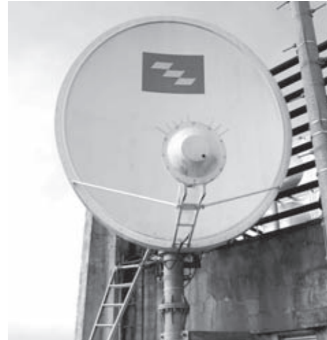
市役所本庁にある衛星受信アンテナ
