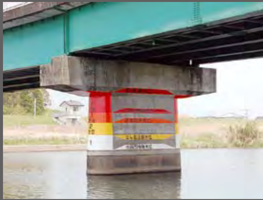
真幸橋下にある真幸観測所
