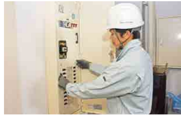
電気工事組合青年部が電気整備点検 プロの技でボランティア
