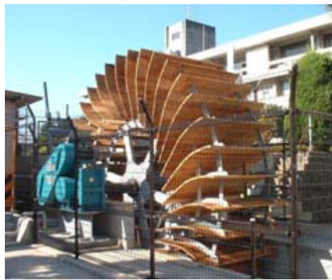
写真：小水力発電機（山梨県都留市）
