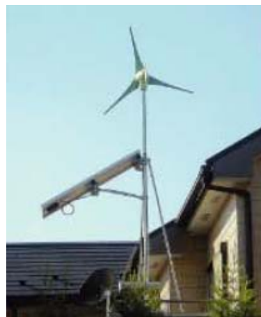
写真：小型風力発電機
