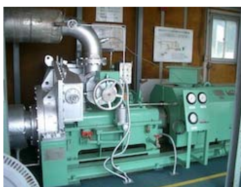
写真：ホテルに設置された地熱発電設備
