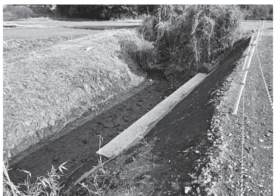
改修要望が出ている金丸川
