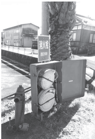
湧水町に設置されている地上式消火栓
