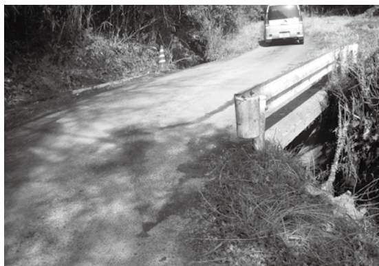
改修が急がれる橋梁
