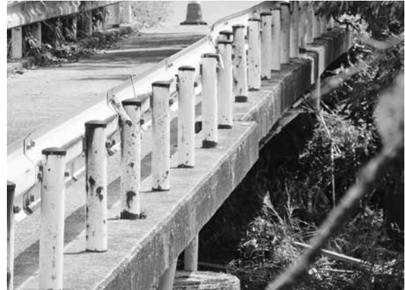
平田橋の横ずれ
