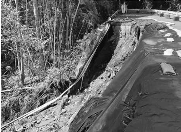
県道403号線の崩壊
