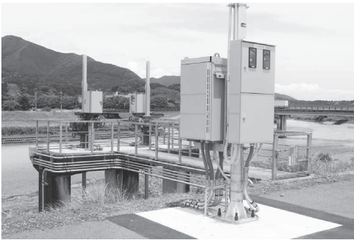
堂本井堰に設置された自動開閉設備
