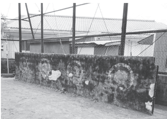
危険箇所と判断され早急に安全対策が図られたブロック塀（飯野小バックネット前）
