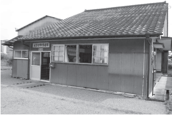
改修が望まれるえびの市営弓道場
