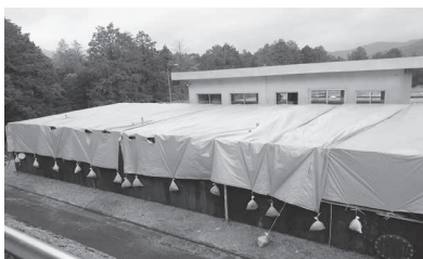
応急的に対処している柿木原浄水場
