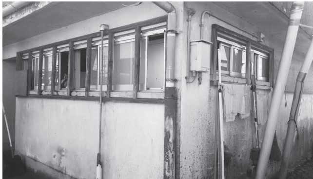
早期改修が求められている飯野駅トイレ
