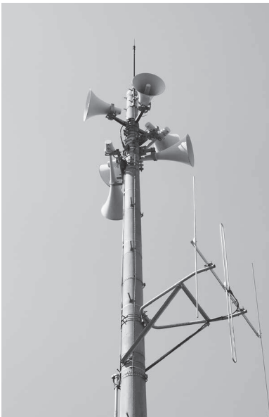
緊急情報・災害時などに活用している防災無線
