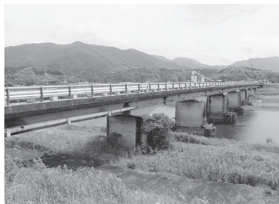
共同企業体での施工が望まれる加久藤橋
