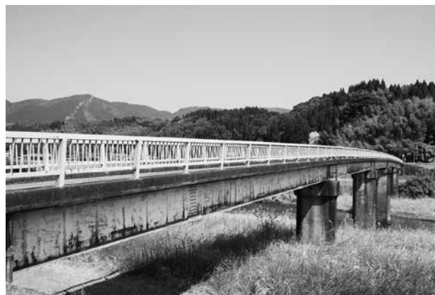
腐食が目立つ徳満橋
