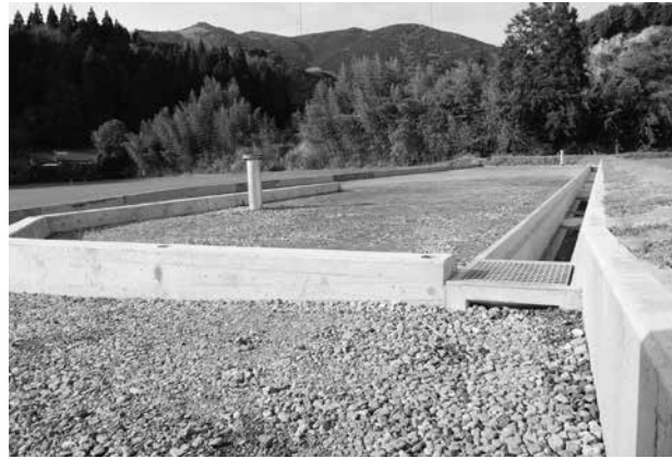
山内地区に整備された第2水源
