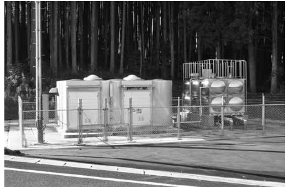
東出水地区と同じ簡易水道統合事業で完成した尾八重野地区の中継ポンプ場
