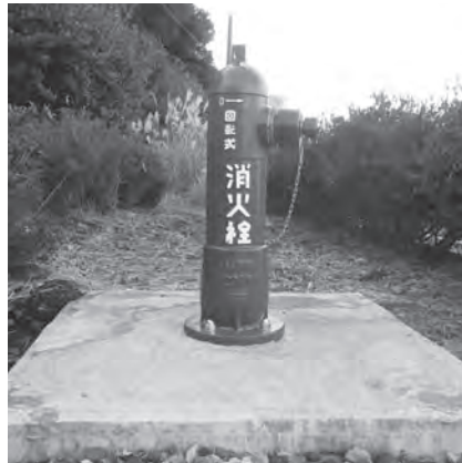
増設が望まれる消火栓
