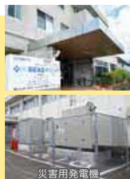
災害用発電機
