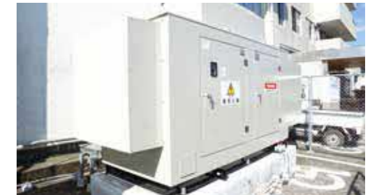
災害時も医療を提供できるように非常用発電機を設置
